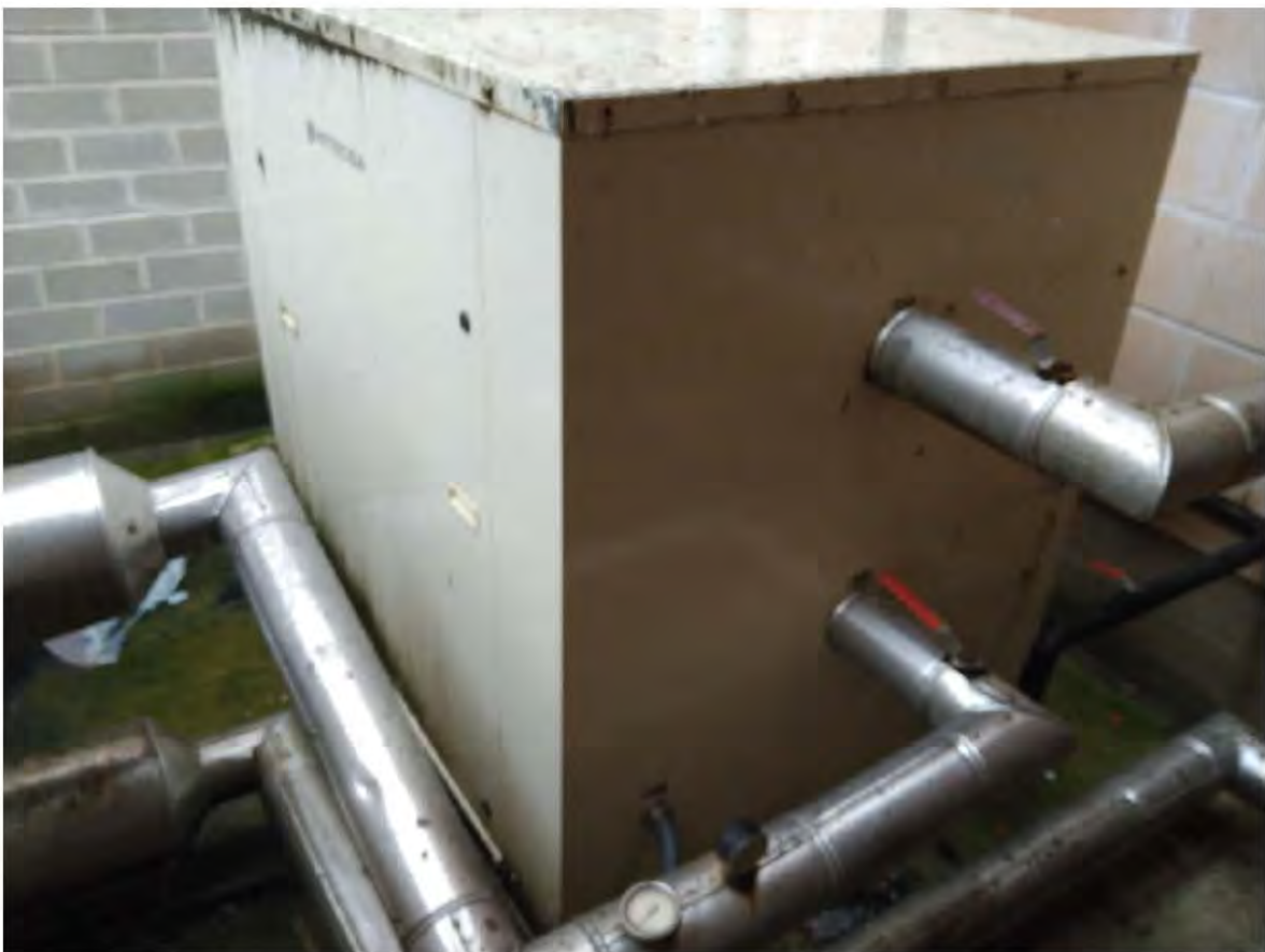
MÓDULO DE INERCIA HITECSA MWI 350 EXISTENTE QUE SE DESECHARÁ
