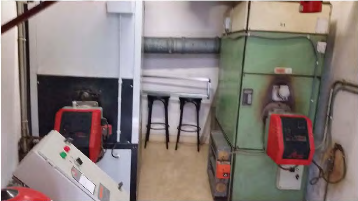
GENERADORES DE AIRE CALIENTE ACTUALES
