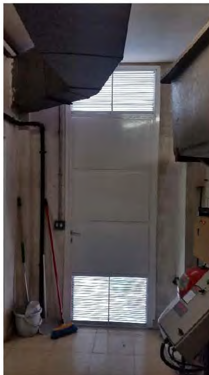
PUERTA DE COMUNICACIÓN CON EXTERIOR DE LA SALA DE CALDERAS
