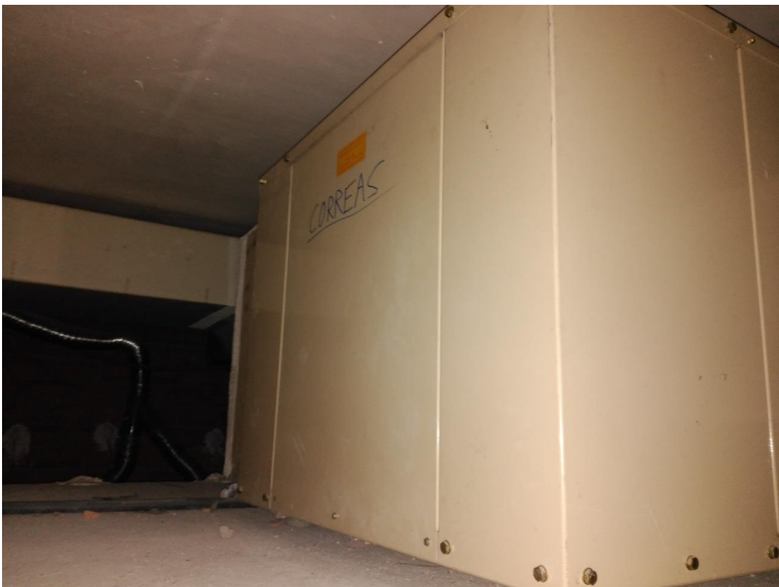
UNIDAD INTERIOR SOBRE FALSO TECHO A RETIRAR
