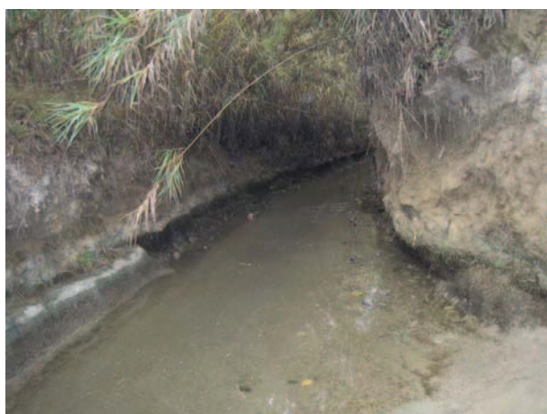
Fotografía 12. Erosión en la parte baja, a ambos lados de la acequia, aguas abajo del PK 0+175. Inicio del Tramo D.
