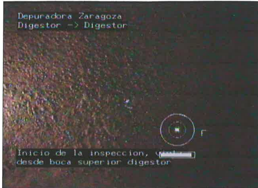
Fotografía: 1a 0,1m, Inicio de la inspeccion, vista desde boca superior digestor
