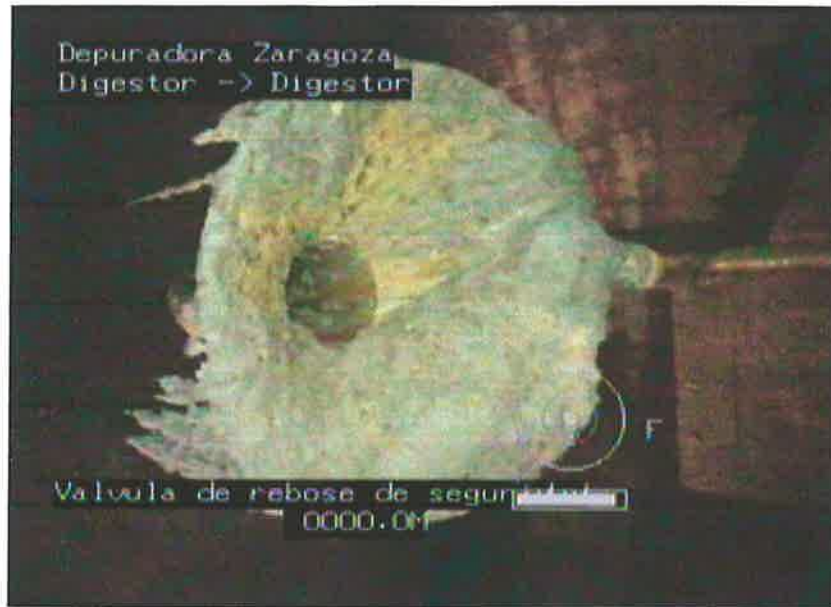
Fotografía: 2a 0,1m, Valvula de rebose de seguridad
