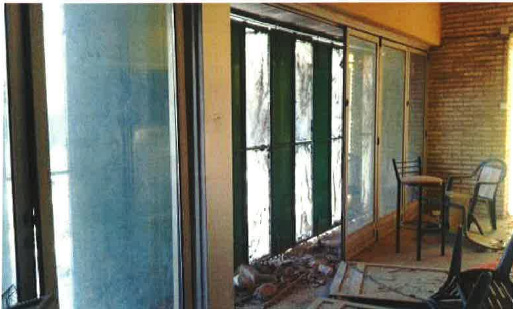
Fotografía nº 4. Vista interior de sala principal (50 m2 aprox.). Carpintería de aluminio completamente vandalizada.
