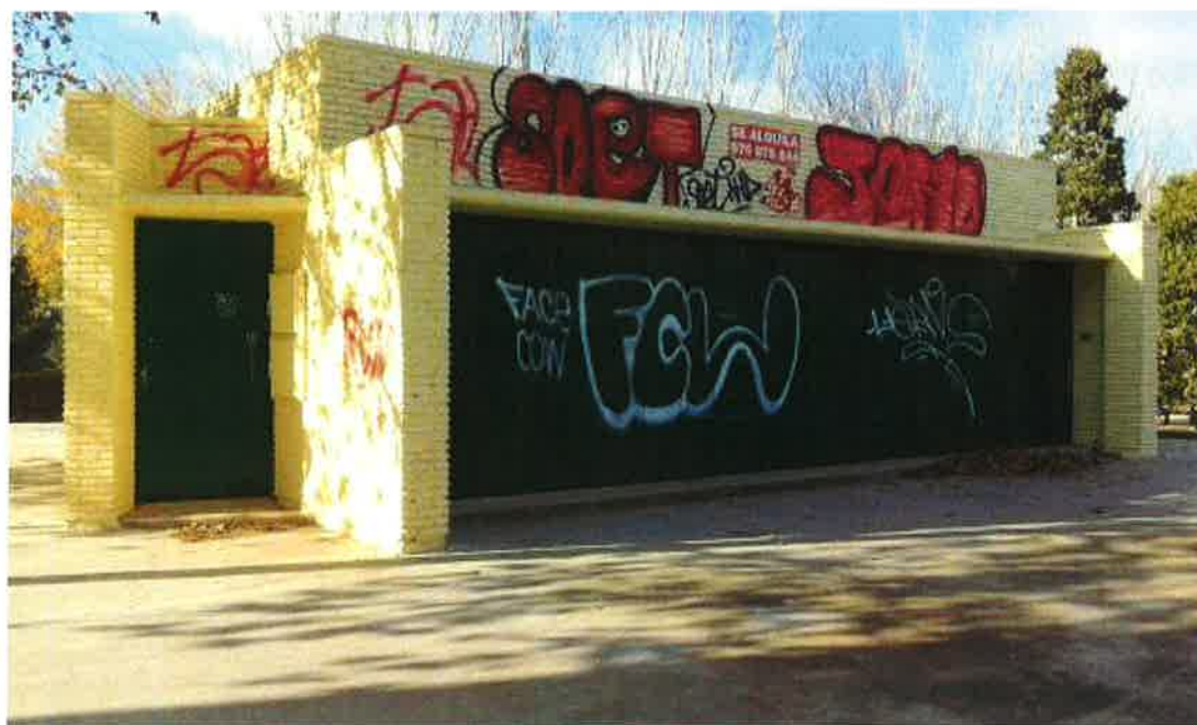
Fotografía nº 2.- Fachada principal con cerramiento metálico (Frontal de 9 m.). El inmueble se encuentra vandalizado y necesita una reforma genérica.
