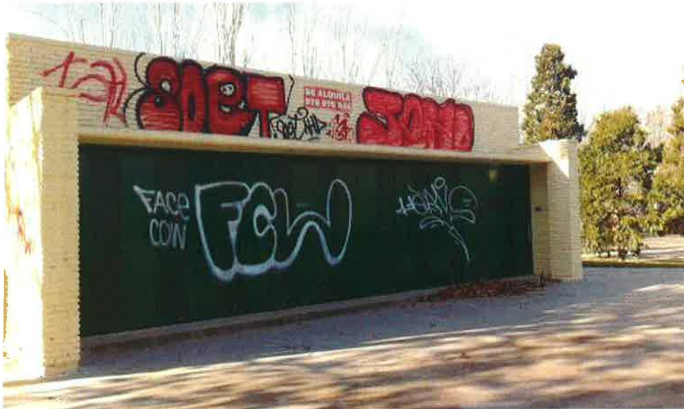
Fotografía nº 1.- Fachada principal con cerramiento metálico (Frontal de 9 m.) El inmueble se encuentra vandalizado y necesita una reforma genérica.
