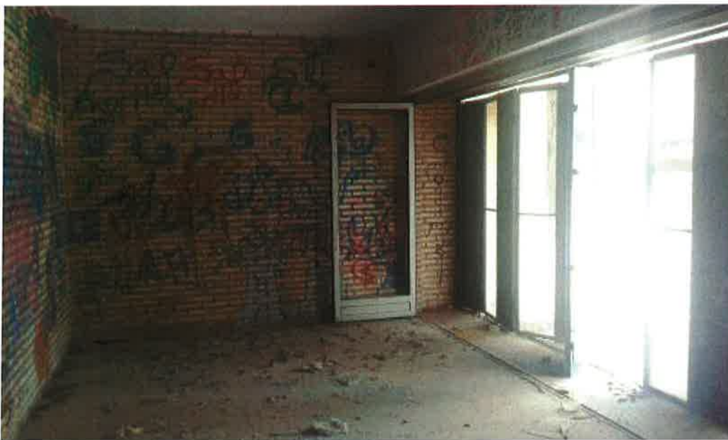
Fotografía nº 2.- Vista interior de sala principal (50 m2 aprox.). Carpintería de aluminio completamente vandalizada.
