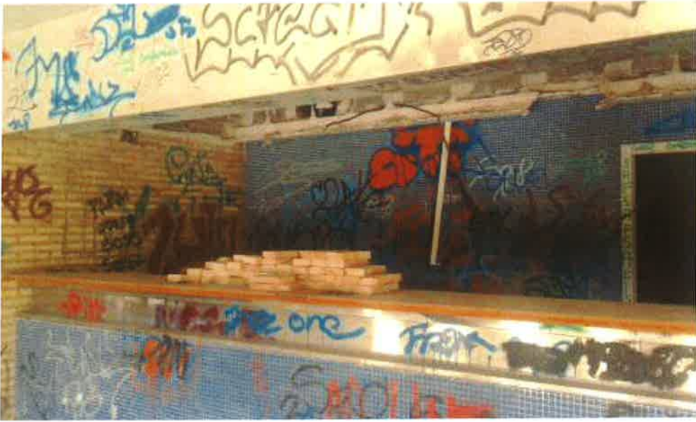
Fotografía nº 3.- Vista interior de antigua barra de bar (Espacio completamente vandalizado). Necesita reforma integral.
