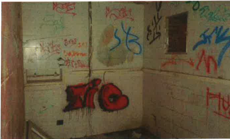
Fotografía nº 4.- Aseos necesitan una reforma integral.
