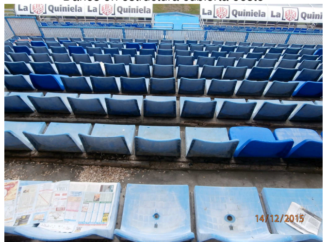
Daños en gradas
