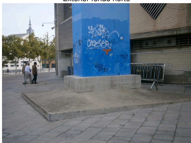
Base fuste torre iluminación
