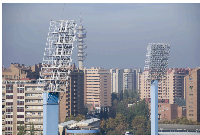
Torres iluminación. Estructura superior focos
