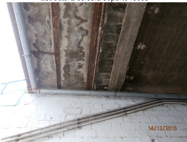
Daños bajo gradas
