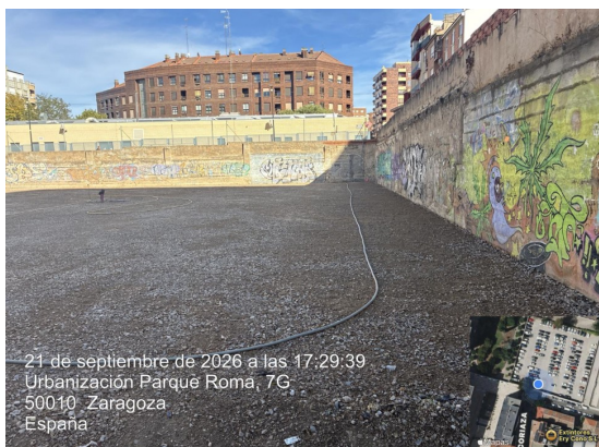
Fotografía 4: Deterioro de los muros de hormigón.
