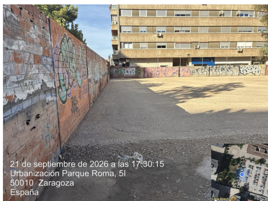
Fotografía 3: Deterioro de los muros de fábrica de ladrillos.
