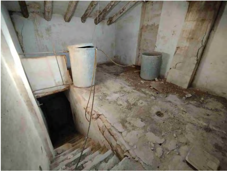
Trastero 2 Bloque A (depósitos de fibrocemento)
