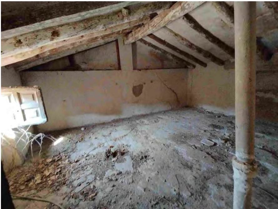
Trastero 1 Bloque A (tubería de fibrocemento)
