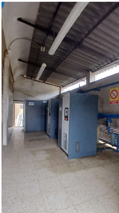
Sala de compresores
