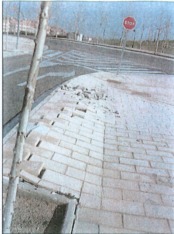
FOTO 1.- Desperfectos en el pavimento de la acera de la C/ Ibón de Anayet en la confluencia con la C/ Lagos de Coronas
