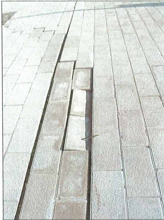
FOTO 4.- Desperfectos en el pavimento de la calle Ibón de Anayet que delimita el área de subsidencia hacia el NE.
