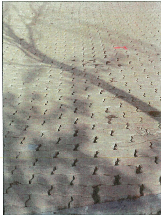
FOTO 5.- Límite de la zona de subsidencia por el norte. Se aprecia un hundimiento en el camino peatonal.
