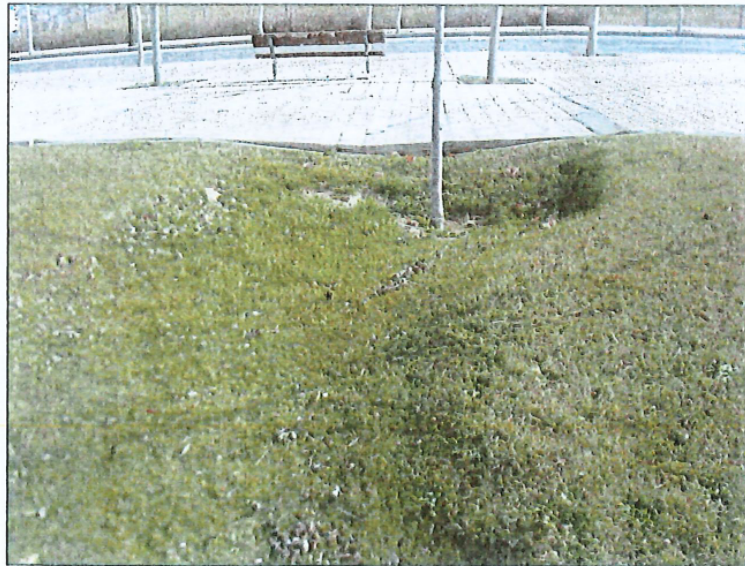
FOTO 2.- Hundimiento en el jardín que continúa por el pavimento de la calle Lagos de Coronas. Límite actual de la zona de subsidencia por el NW.
