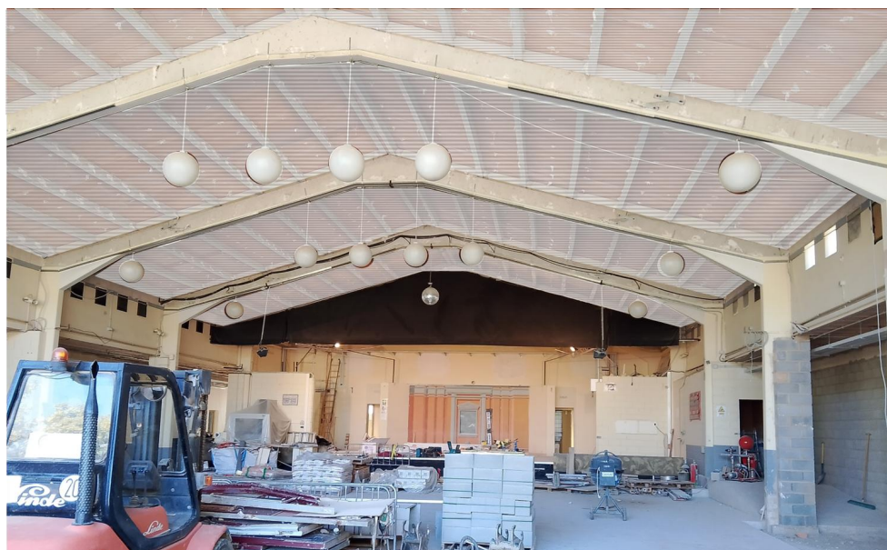
Figura 5. Disposición del revestimiento fonoabsorbente en la cubierta del pabellón multiusos.
