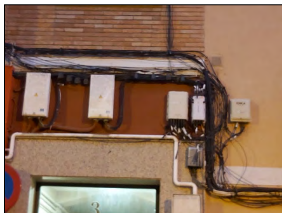
CABLEADO Y CAJAS GRAPADAS A FACHADAS
