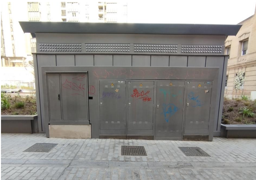
HUECO 05. ARMARIOS DE ELECTRICIDAD
