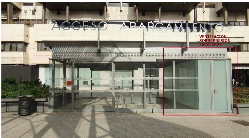
HUECO 02. CASETÓN SOBREPRESIÓN ESCALERAS
