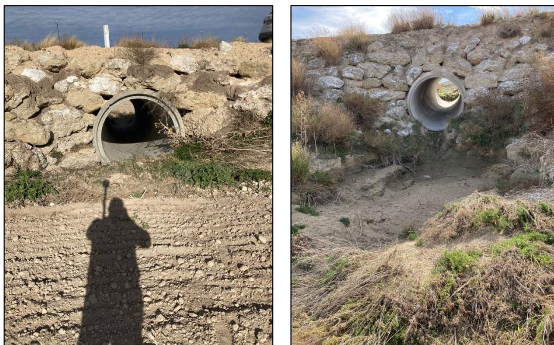
Ilustración 14. A la izquierda, sección de aguas arriba de la conducción existente de 1800 mm de DN. A la derecha, sección de aguas abajo. Dique superior oeste.
