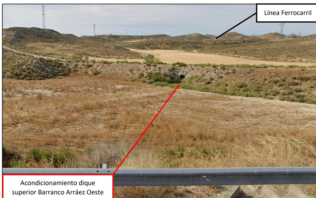
Ilustración 13. Vista desde aguas abajo del dique superior oeste del barranco de Arráez desde el carril de aceleración de la Z-40. Al fondo, línea ferroviaria.
