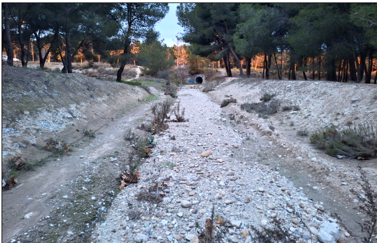
Ilustración 50. Lengua de sedimentos aguas arriba de la obra de fábrica y conducción de Ø1800 mm de diámetro nominal.
