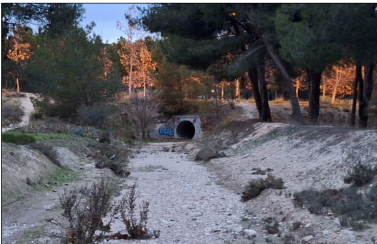
Ilustración 44. Vista desde aguas arriba del canal y obra de fábrica de la conducción de 1800 mm de DN.
