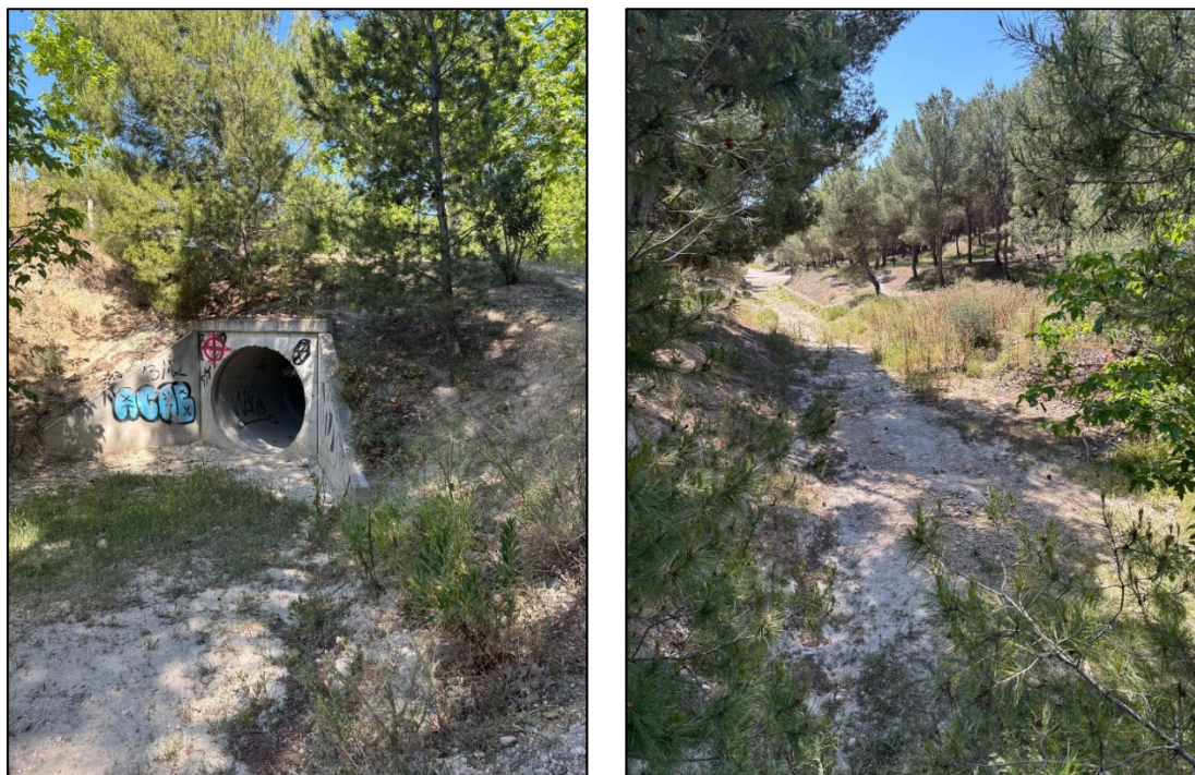
Ilustración 7. Acondicionamiento del barranco de Arráez. A la izquierda, Obra de Drenaje Transversal bajo el vial de la Av. de Puerto Venecia. A la derecha, vista hacia aguas arriba del ‘canal’ del barranco de Arráez.
