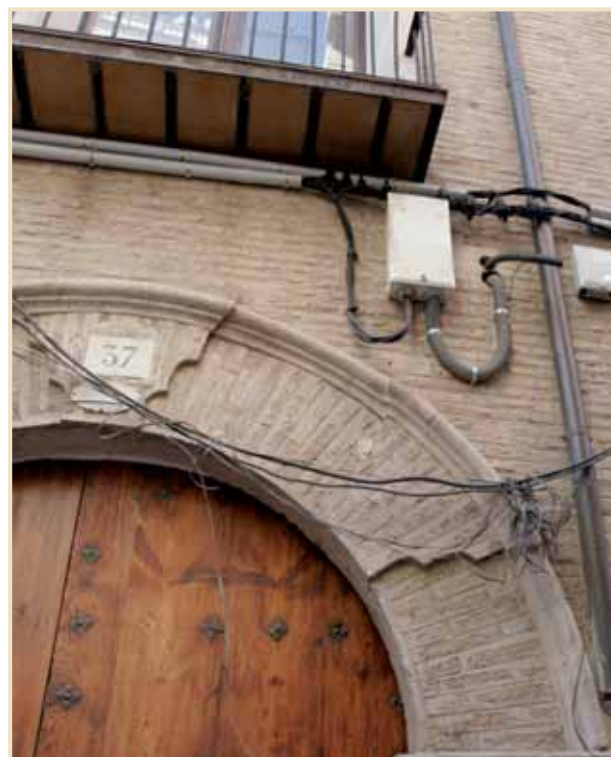
Cableados / Foto: F. Bernad, D. Marcos
