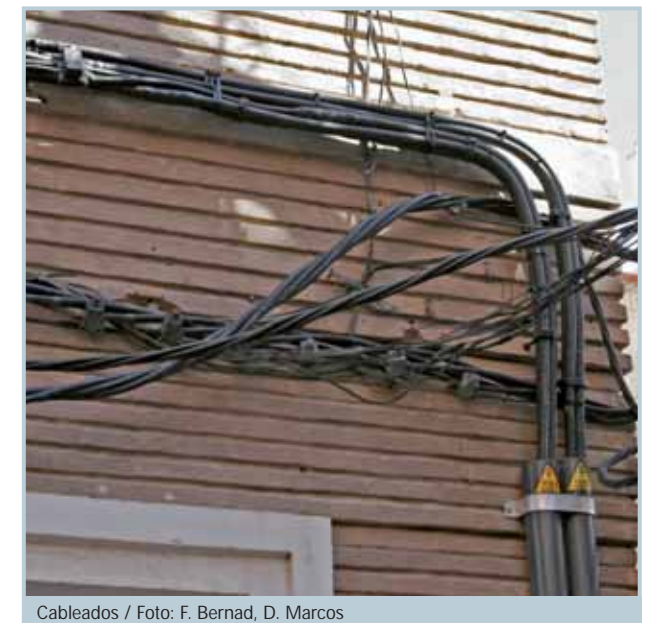
Cableados / Foto: F. Bernad, D. Marcos
