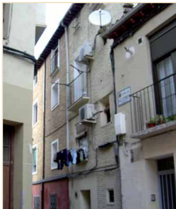
Aires acondicionados y antenas
