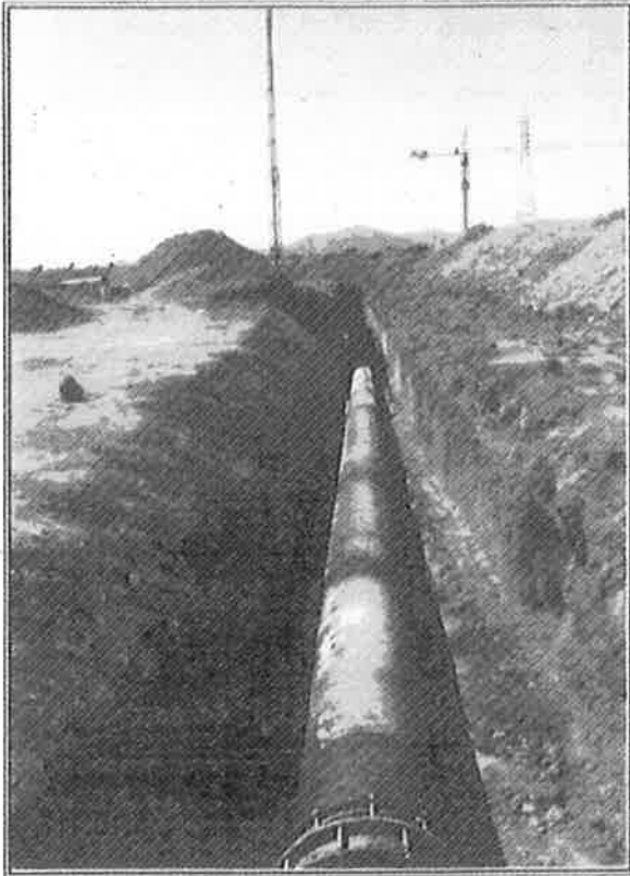
Red general. Detalle tubería acoplada.
