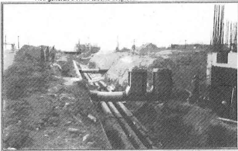
Red general. Detalle piezas de conexión a buzones de vertido.
