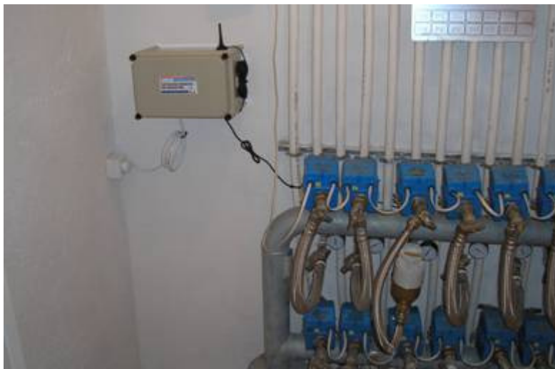
Figura 8.- Estación remota de registro y control
