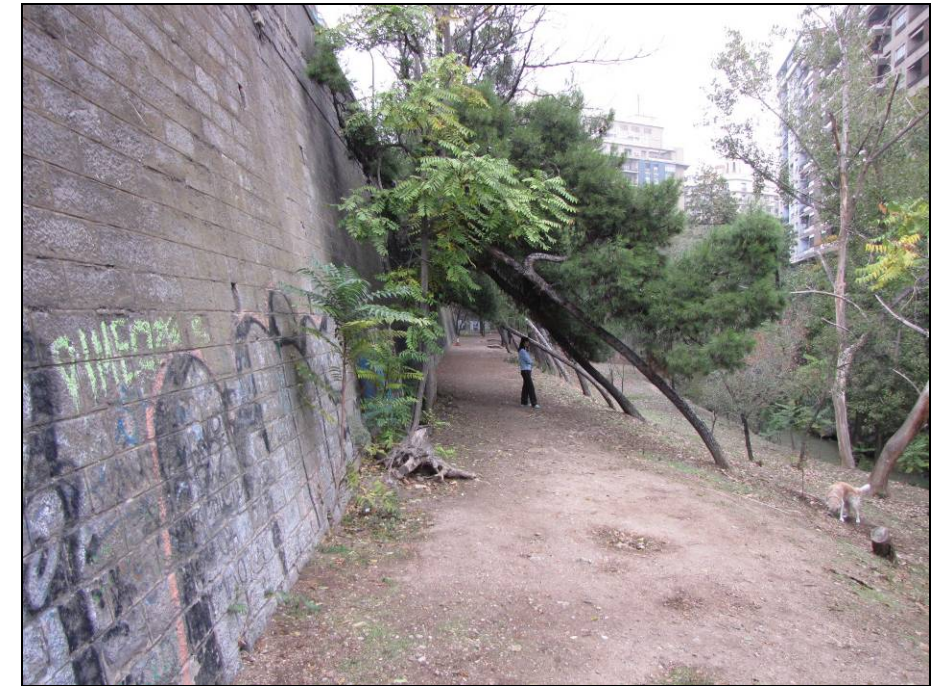
Hilera de pinos inclinados hacia el muro
