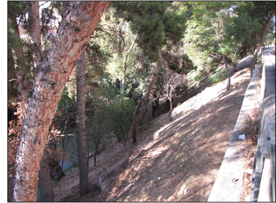
Talud existente en el que se observa el mal estado de la vegetación
