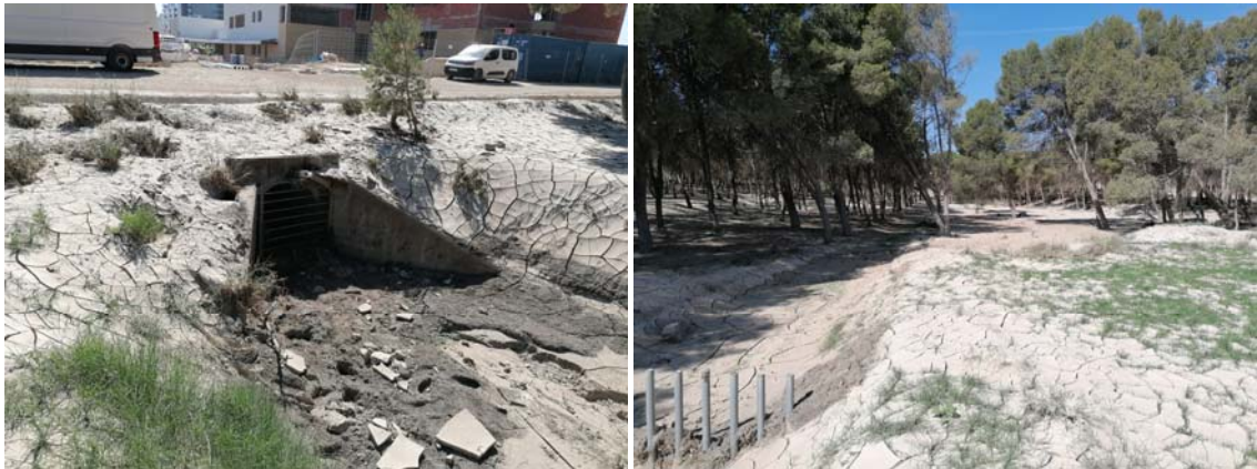
Canalización y obra de captación del barranco de la Muerte frente al CEIP María Zambrano (Fuente: Google Maps).
