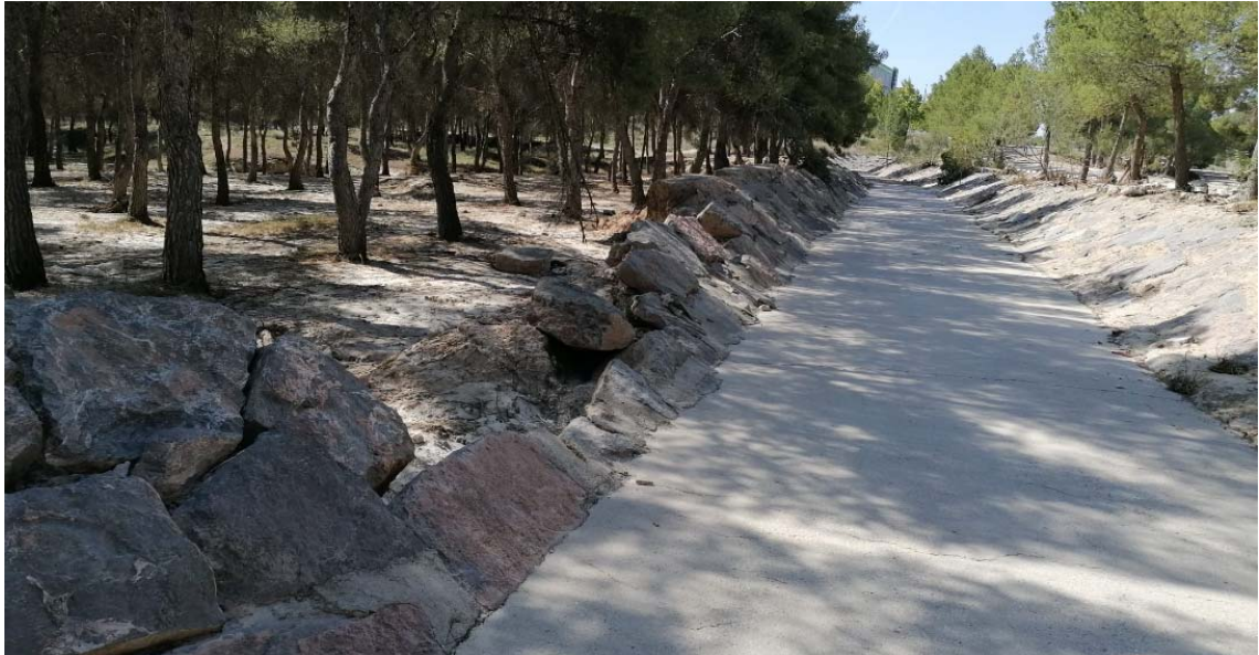
Encauzamiento desde Z-40 hasta parque del Barranco. Vease roturas en margen derecha. (Vista hacia aguas arriba).
