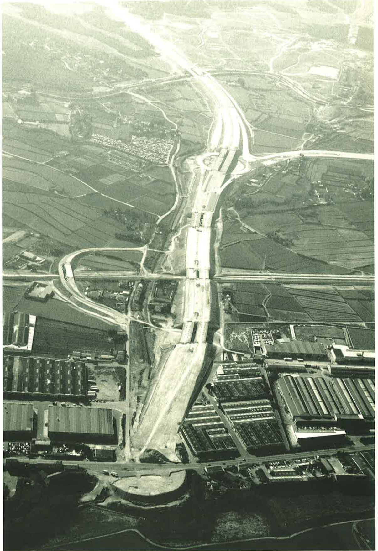
Obras del Cuarto Cinturón en su cruce con la carretera de Castellón
