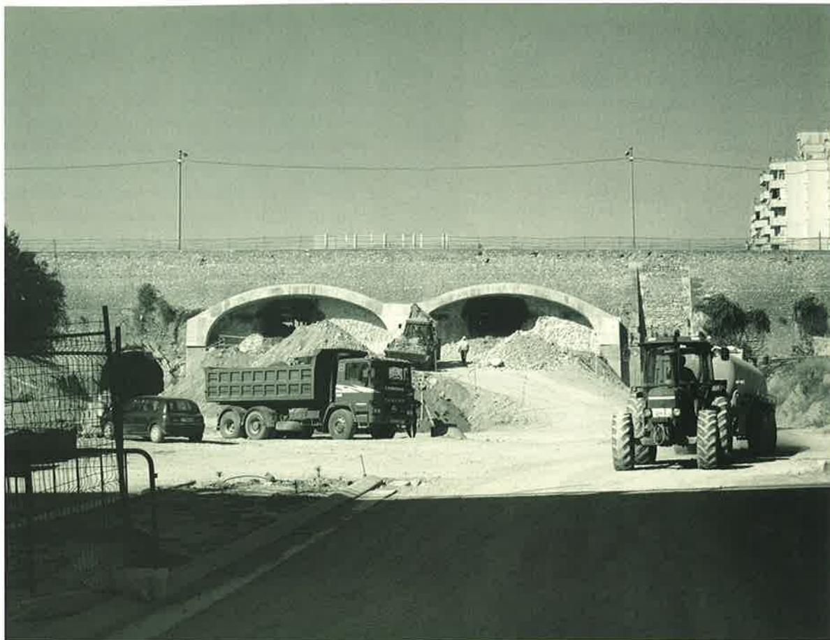
Obras del Tercer Cinturón en el acueducto del barranco de la Muerte
