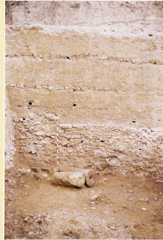
Vista de la cara interior del paramento encofrado de la muralla en la c/ Sepulcro, 1-15.
