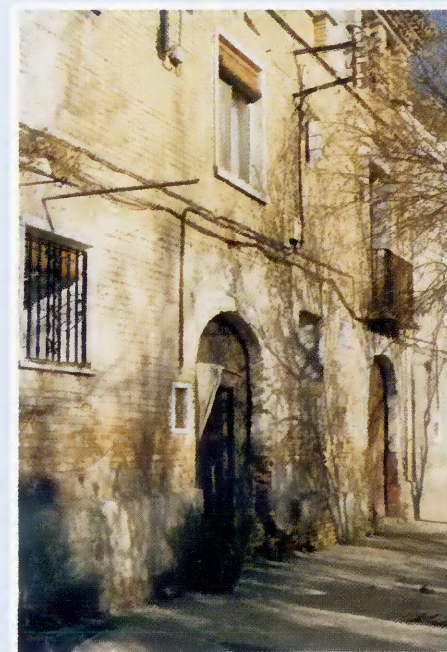
Estado anterior de la fachada
