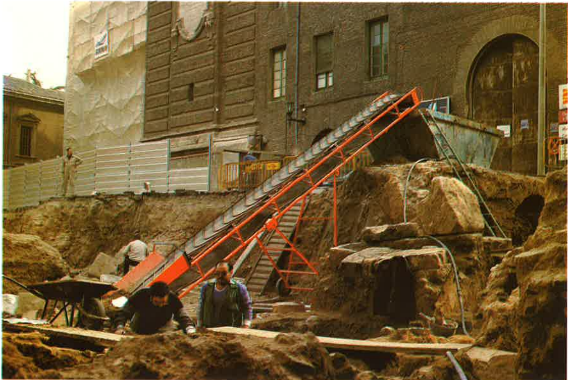
Trabajo manual y medios mecánicos para evacuación de tierras estériles. (Foto: J. A. Pérez Casas).
