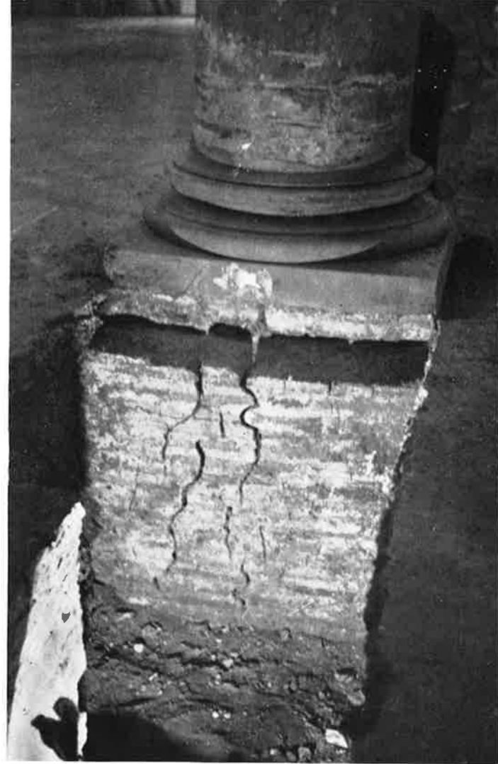
Columnas sin apoyo firme
