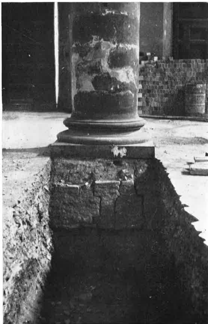
Pandeo de las columnas.
