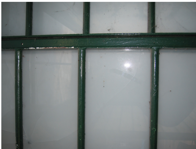
(011) – VIDRIOS LATERALES ROTOS
