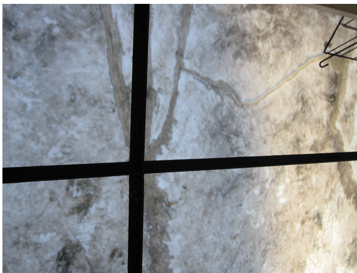
(013) – VIDRIOS TECHO ROTOS (2)
