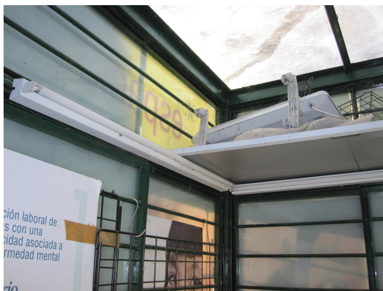
(012) – VIDRIOS TECHO ROTOS (1)
