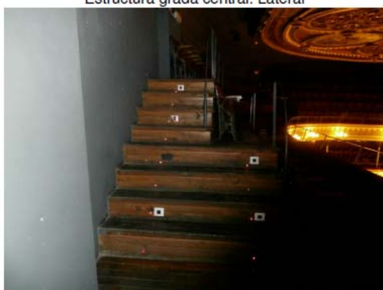
Peldaños acceso a grada lateral.
