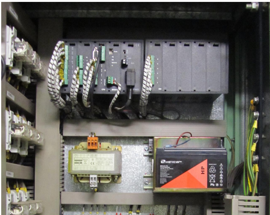
Equipos de telecontrol existente.
