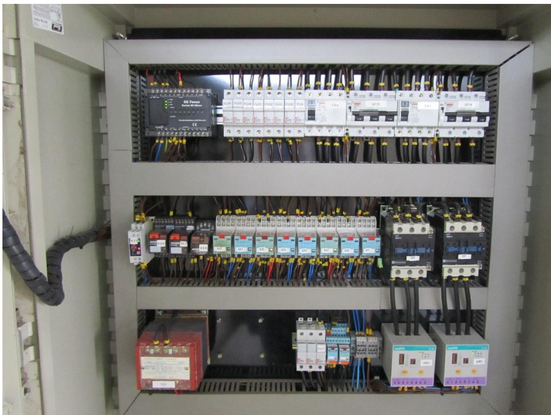
Armario de control existente.
