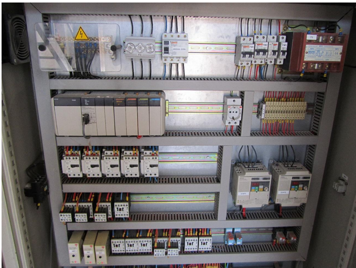
Armario de control de poli deshidratación existente.
