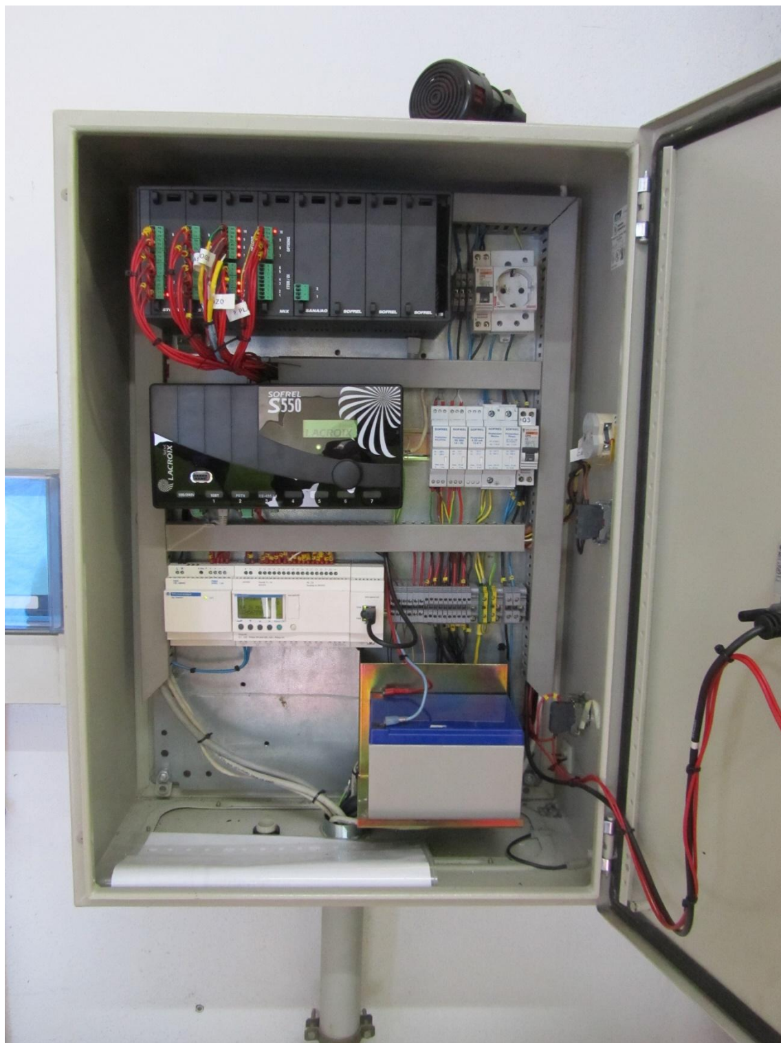
Equipos de telecontrol existente.
