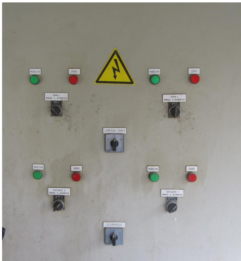
Pulsantería para el control local.
