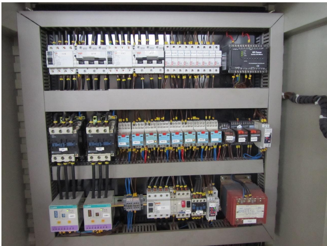
Armario de control existente.
