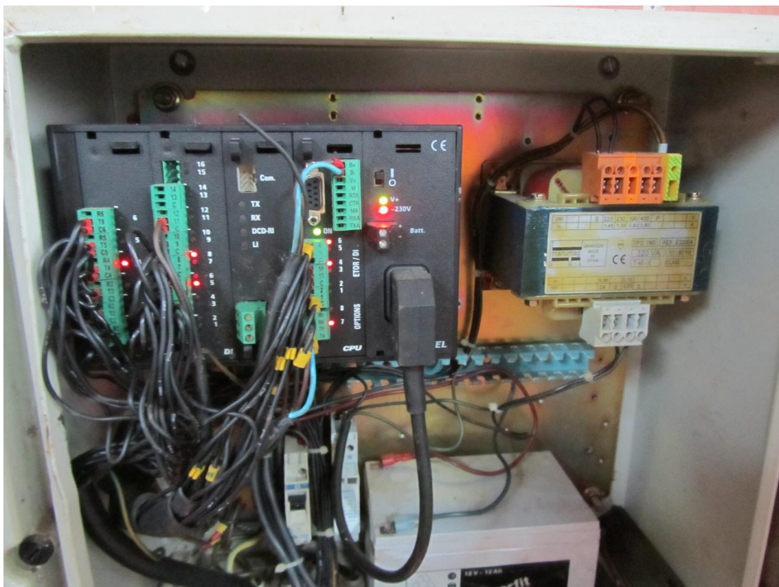
Equipos de telecontrol existente.
