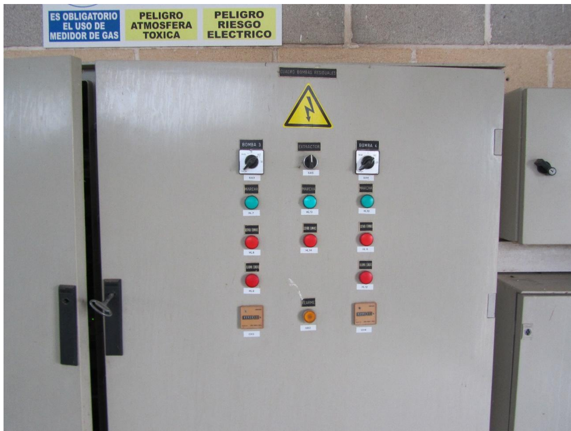
Pulsantería para el control local.
