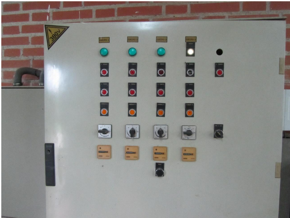
Pulsantería para el control local.
