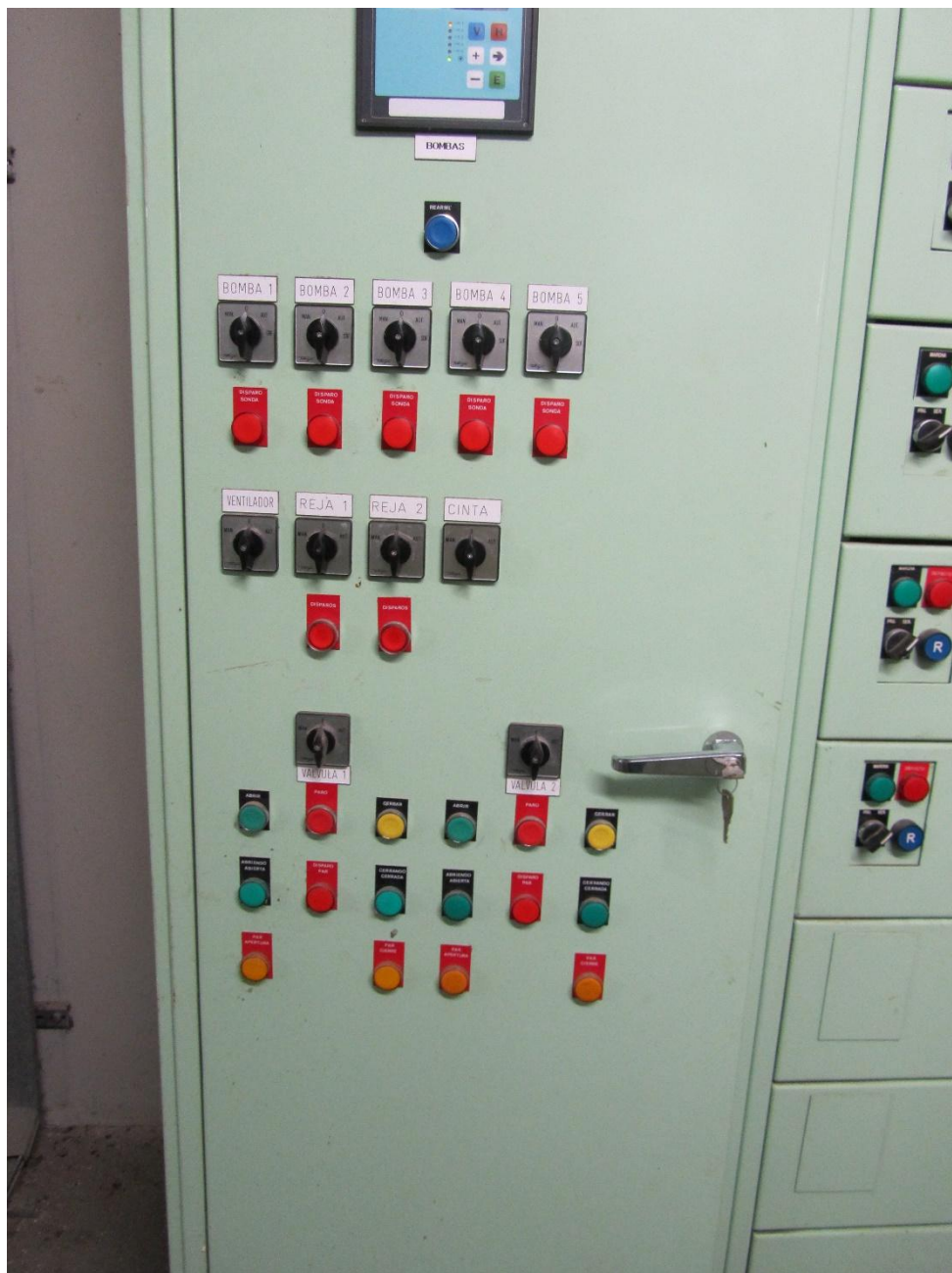
Pulsantería para el control local.
