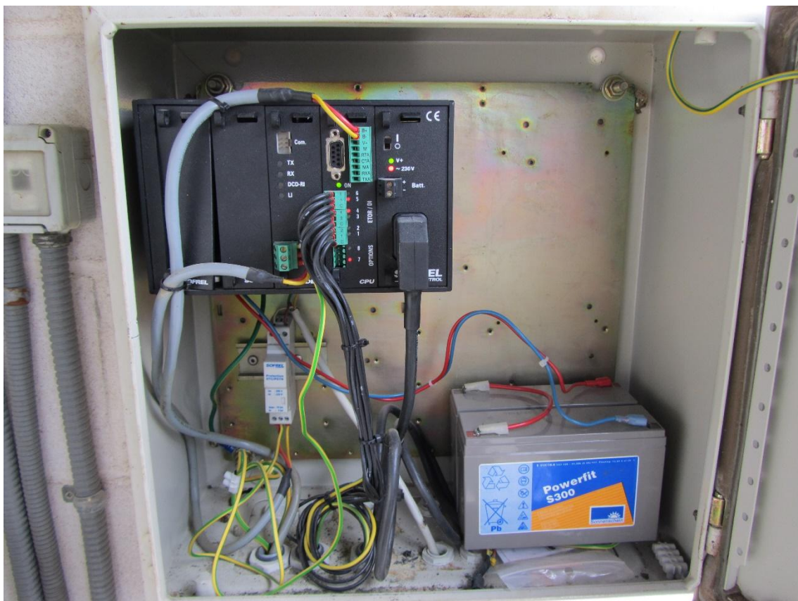
Equipos de telecontrol existente.
