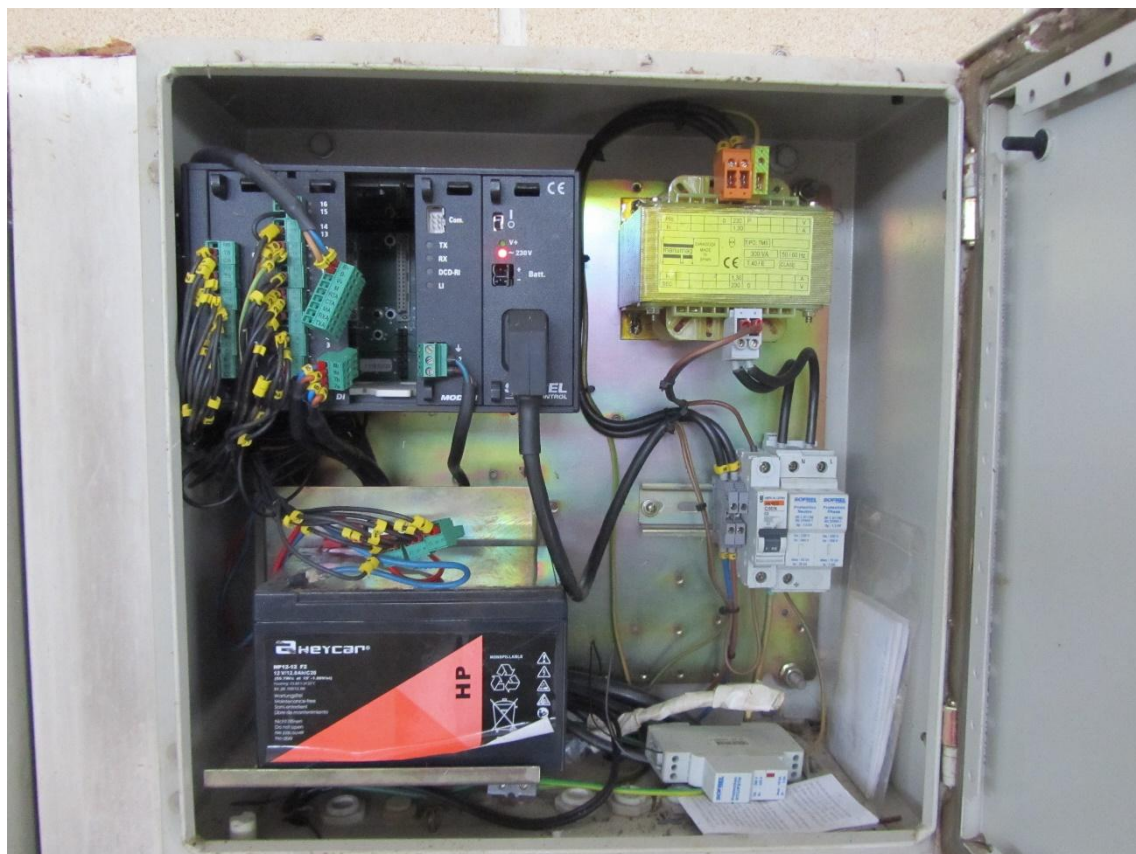
Equipos de telecontrol existente.
