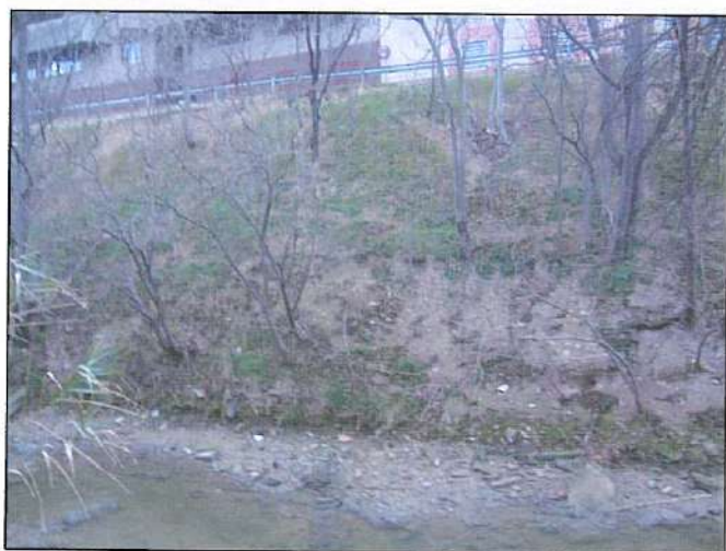
Fotografía 23.- Zona de rellenos hasta el mismo cauce bajo la calle Genoveva Torres.
