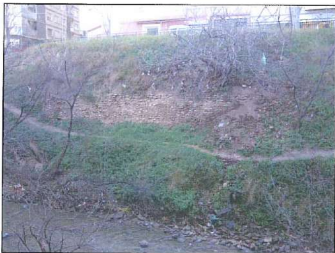
Fotografía 9.- Calle Manuel Lasala, Margen izquierda. Existen muros y rellenos llegando casi hasta el cauce.
