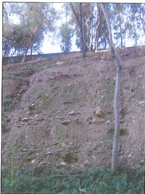
Fotografía 22.- Rellenos y muros muy pobres que bajan hasta el paseo junto al cauce casi bajo la avenida Goya.
