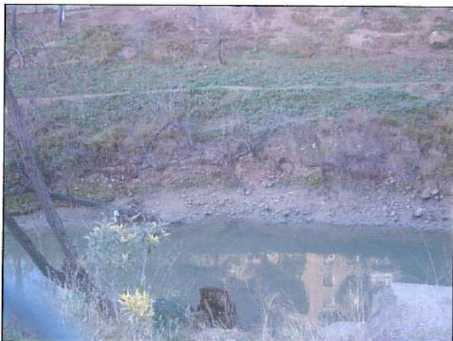
Fotografía 1.- Desde el final de la Calle Cervantes. En la base del talud de la margen izquierda pueden verse las gravas
