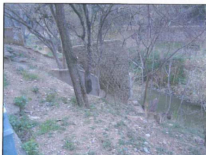
Fotografía 6.- Calle Genoveva Torres. Margen derecha con rellenos. Ver patologías de giro (movimiento) en árboles y en el muro.
