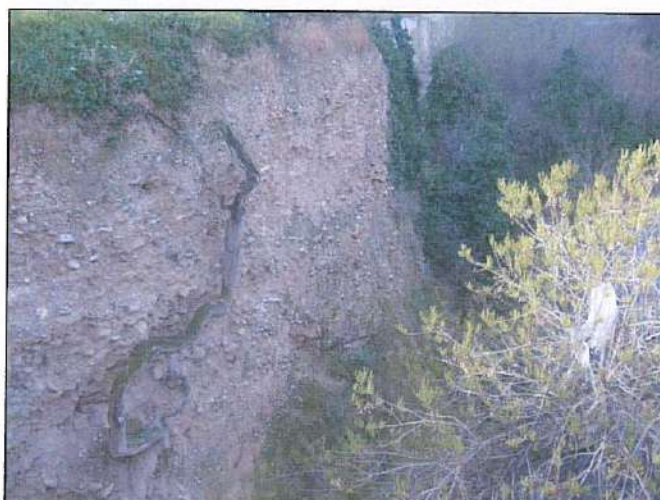
Fotografía 12.- Junto a la pasarela peatonal en calle Marina Española con gravas densas y cementadas.
