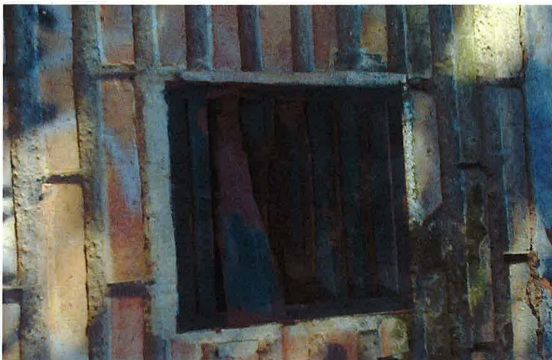
Rejillas exteriores a reparar
