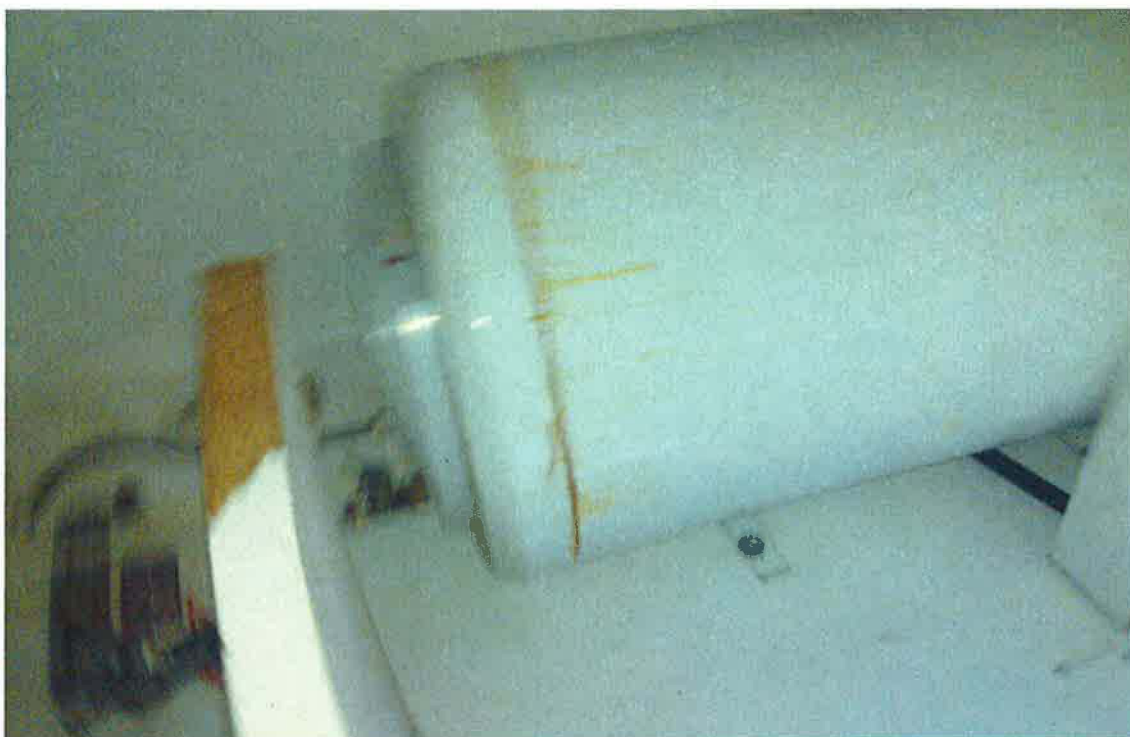
Revisión instalación fontanería
