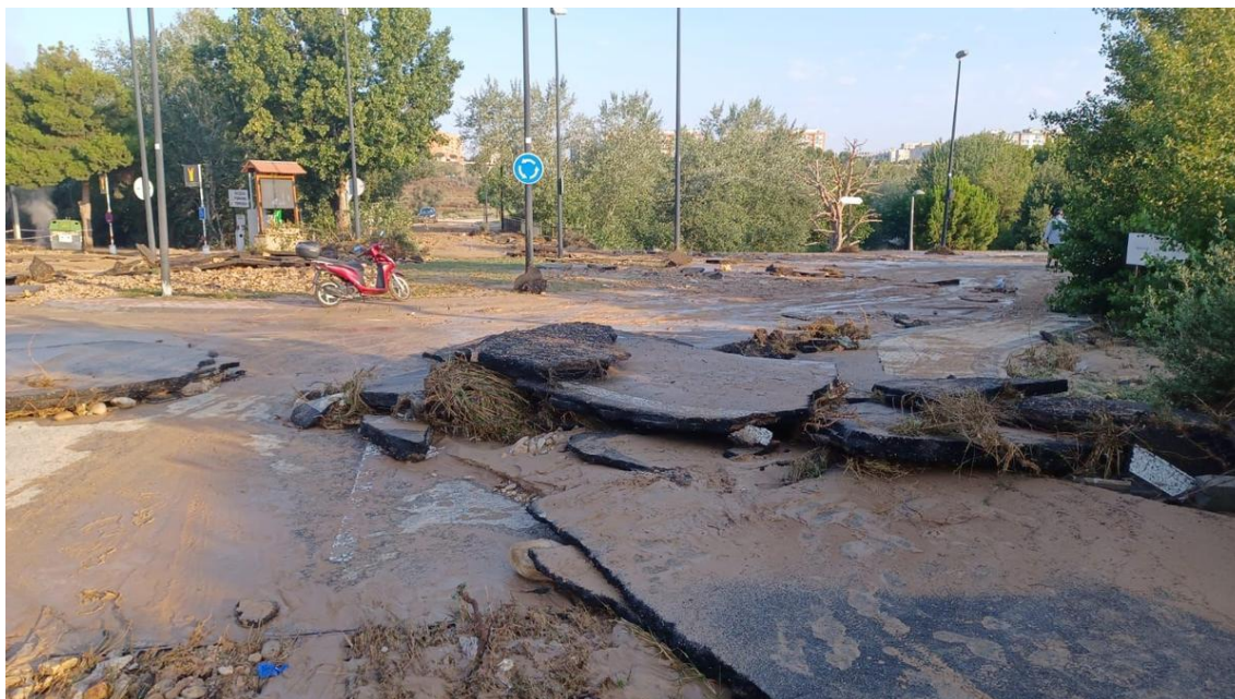
Imagen: Estado en que quedó la rotonda de acceso a la Fuente de la Junquera tras las tormentas del 6 de julio de 2023
