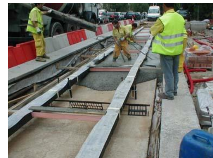
Ilustración 26. Sistema de vía estuchada. Detalle del proceso de hormigonado y juntas transversales tipo JRI
