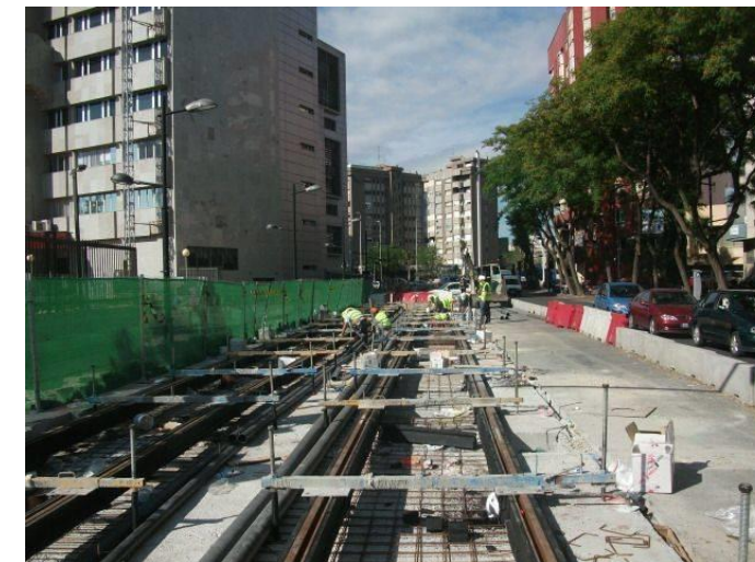
Ilustración 38. Sección vía embebida con carril pre-revestido. Tranvía de Murcia. Montaje de superestructura
