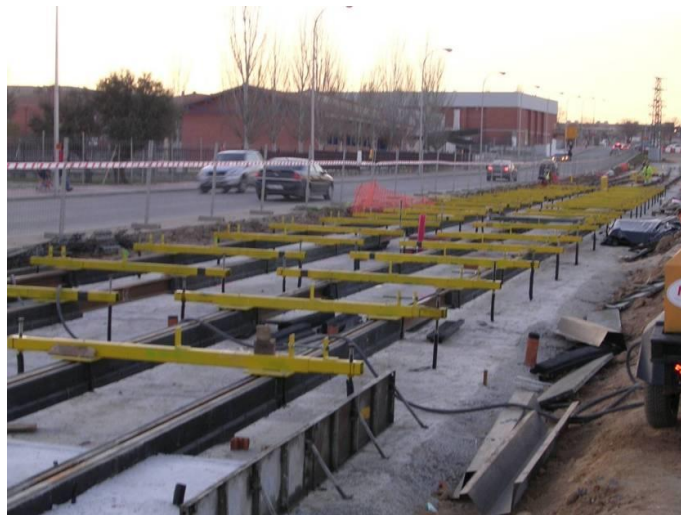
Ilustración 36. Sección vía embebida con carril pre-revestido. Tranvía de Parla. Montaje de superestructura
