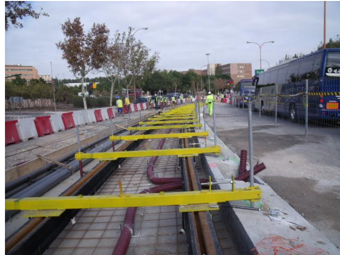
Ilustración 39. Sección vía embebida con carril pre-revestido. Tranvía de Murcia. Montaje de superestructura (2)
