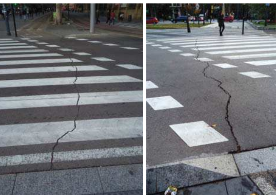
Fisuras en el pavimento de la plaza Paraíso marcando el trasdós del estribo izquierdo del puente de Santa Engracia
