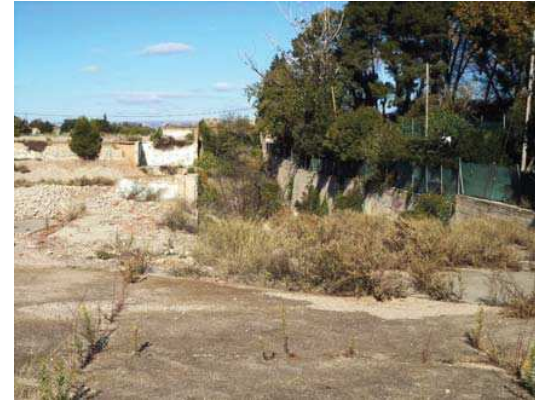
Hundimiento kárstico en la margen norte de la carretera de Madrid N-IIa a 80 m del inicio del trazado
