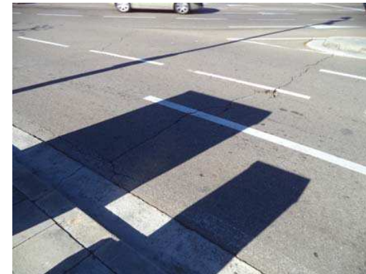
Fisuras en el pavimento de la plaza de la Ciudadanía
