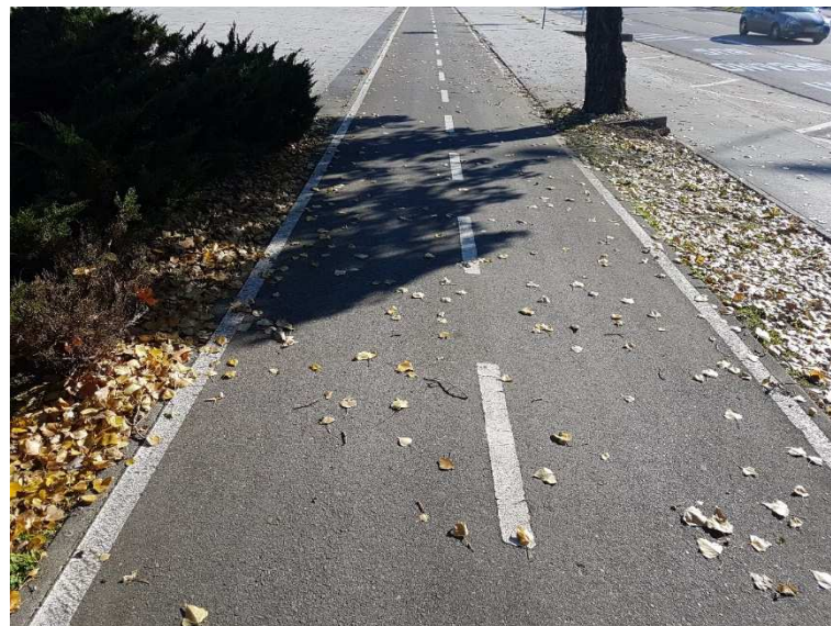
Ilustración 54: detalle del carril bici existente de ancho 2,50 metros en la Av. Navarra
