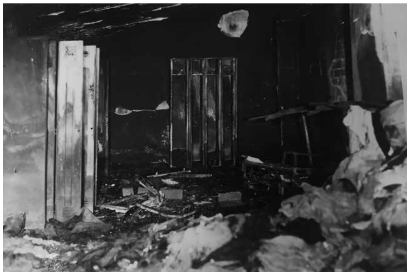
Así quedaron los vestuarios tras el incendio. A su derecha se situaba el espacio donde se encontraba el transformador, comunicado con el vestuario a través de una rejilla de ventilación.
