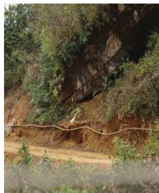
При строительстве дороги в Непале обнажилась секция трубопровода системы водоснабжения, выполненного из полиэтилена низкого давления. Автомобиль может повредить этот трубопровод (опасное событие), вызвав перебои в снабжении безопасной питьевой водой примерно 70 домохозяйств (риск).
