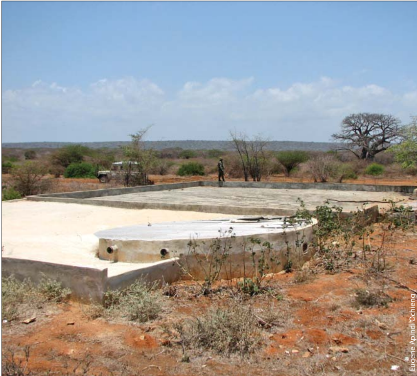
Cette citerne en béton dans le nord-est du Kenya recueille l'eau de pluie et la dévie vers une citerne de stockage souterraine pour une utilisation ultérieure
