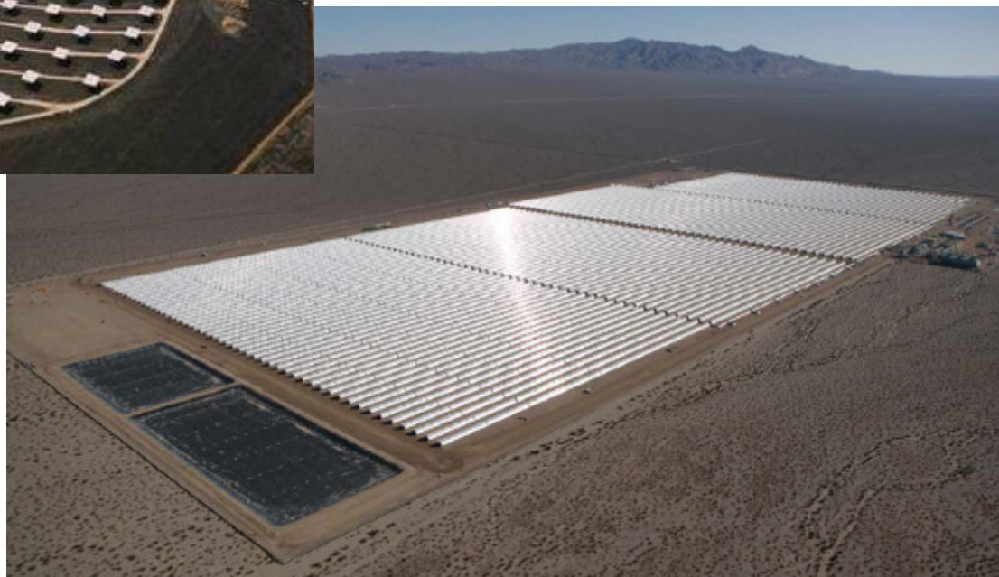
NEVADA SOLAR ONE (ACCIONA-SOLARGENIX) 64 MWe; Las Vegas (Nevada, USA), Julio 2007
