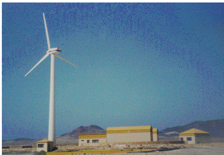
Figura 7. Instalación Eólica (225 kW) / Diesel (160 kW) acoplada a planta de ósmosis inversa (52 m 3 /día) en Fuerteventura
